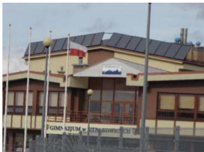
Solary na budynku Szkoły Podstawowej nr 2 w Sierakowicach. Źródło: własne
